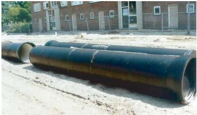
Figure 4.35. DI pipe length.
