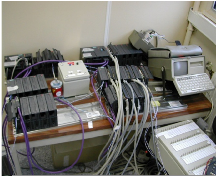
Fig. 19. PLC Input /Output Module
