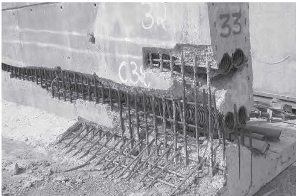
Figure 9.26 Failed web pour (Photo: Robert Benaim)
