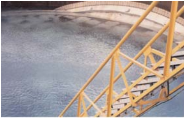
a. Roof sunk
