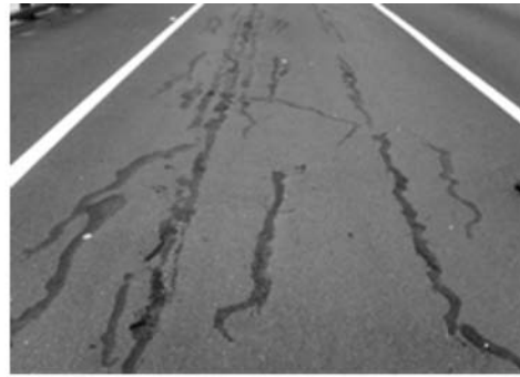
b: SMA longitudinal crack
