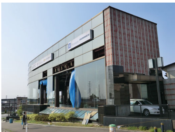
Fig. 8.38 Fallen cladding (Miyagino, Sendai)
