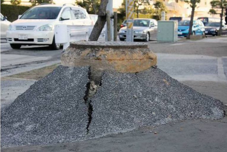
Fig. 10.10 Uplift of manhole
